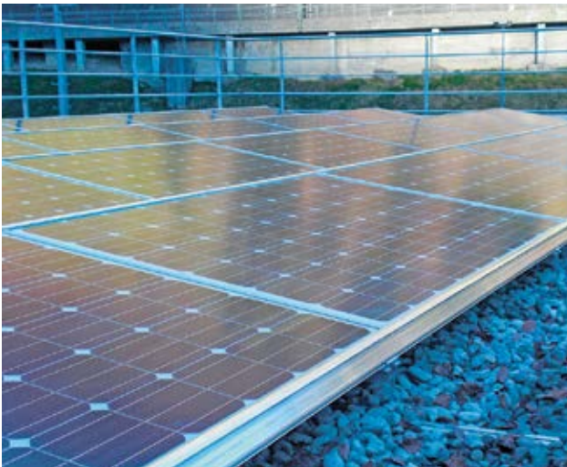
Bild 4 Solaranlage auf Flachdach mit umlaufendem permanentem Geländer
