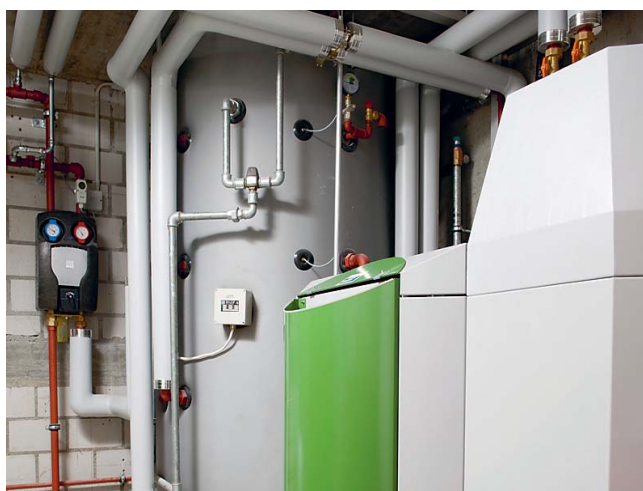
La caldaia a pellet di casa Reist
