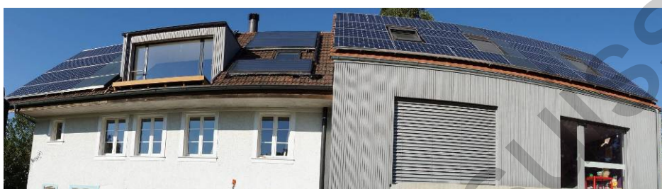
Photo 1 : Installation PV raccordée au réseau
