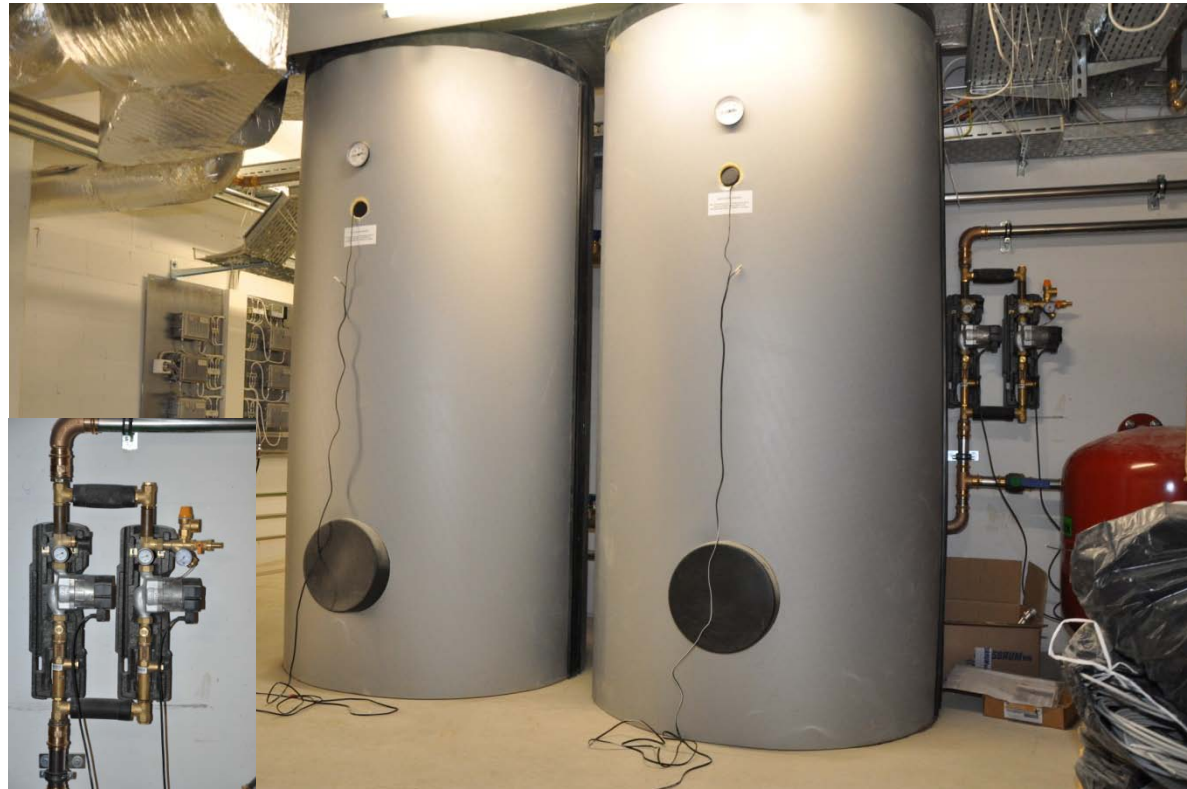
Solar-Vorwärmespeicher 2 x 1000Ltr.
