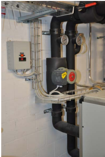
Raum-Kühlung über Erdsonden
