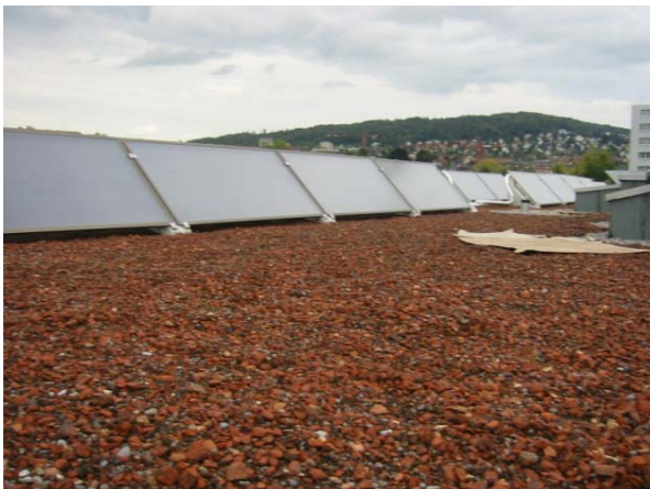
Kollektorfeld auf dem Flachdach
