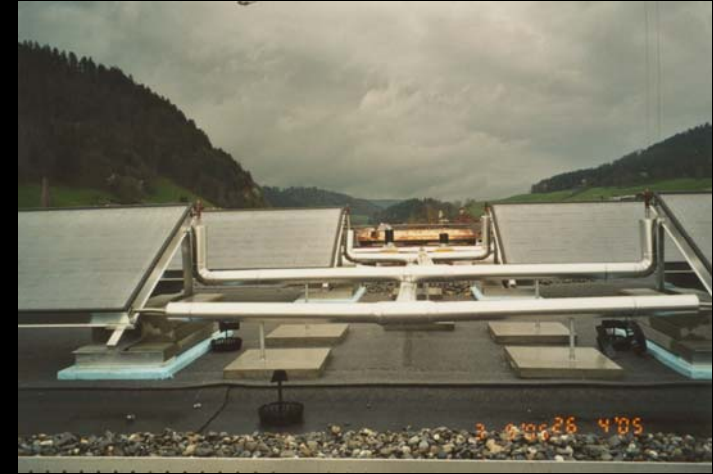
Wohnüberbauung Mattenpark Oberdiessbach - Verbindungsleitungen Kollektoren
