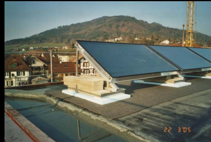
Wohnüberbauung Mattenpark Oberdiessbach - Sonnenkollektoren Fabr. Schweizer (LTS 527)
