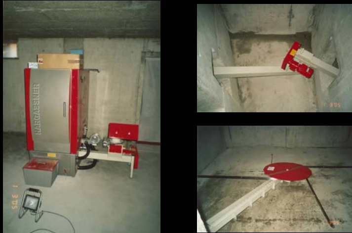
Wohnüberbauung Mattenpark Oberdiessbach - Heizkessel Hargassner 100 kW, Gschwind Heiztechnik AG Gösgen
