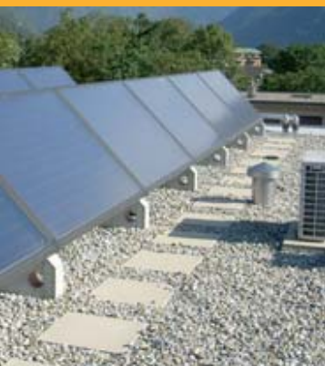
I collettori sul tetto della Residenza Al Parco a Sementina.
