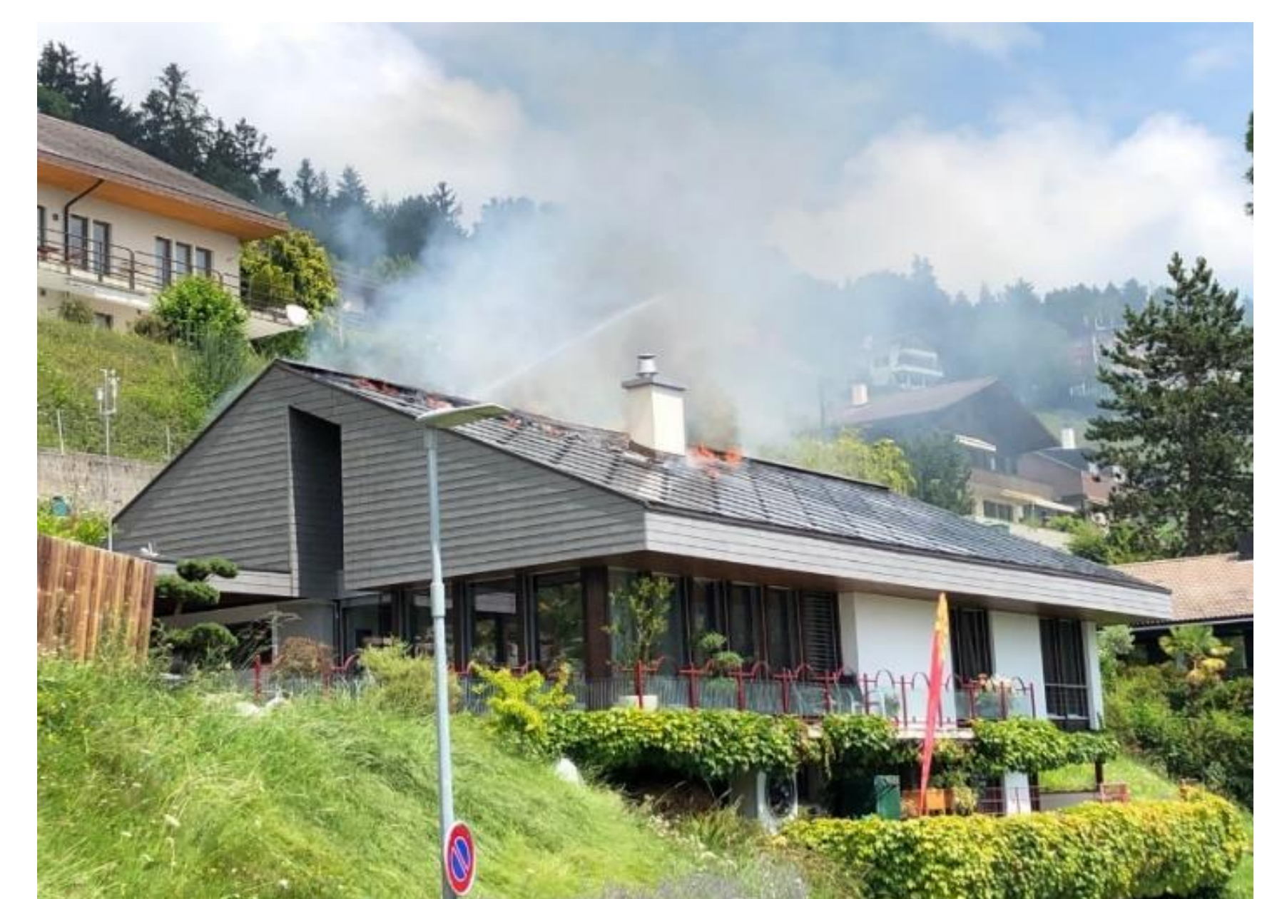
Brand einer PV Indach-Anlage bei Thun im Sommer 2021. Foto: Urs Muntwyler.
