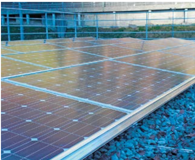
Bild 4 Solaranlage auf Flachdach mit umlaufendem permanentem Geländer
