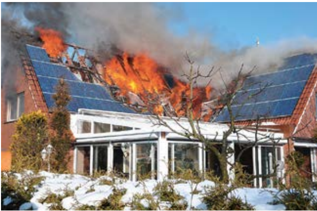
Bild 20 Brandfall bei Haus mit Solaranlage
