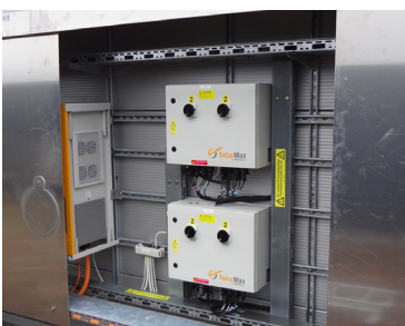
Séparation interne des canalisations AC et DC, ainsi que des canalisations protégées et non protégées
