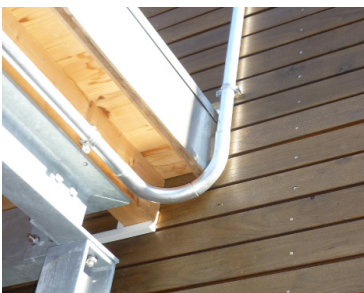
Canalisation DC en tube de protection incombustible RF1 sur façade bois combustible
