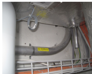
Canalisation DC en conduit aluminium totalement fermé avec marquage
