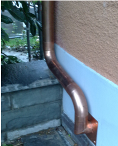
Canalisations DC en tube de protection RF2 et dans descente de gouttière cuivre RF1 sur la façade extérieure
