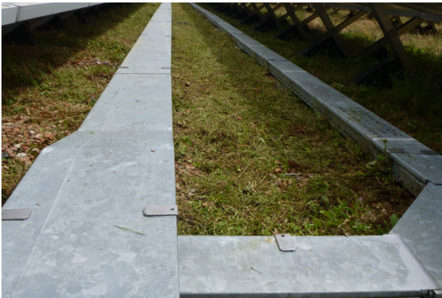
Figure 9: Passage des câbles entre les modules PV, source: Contec
