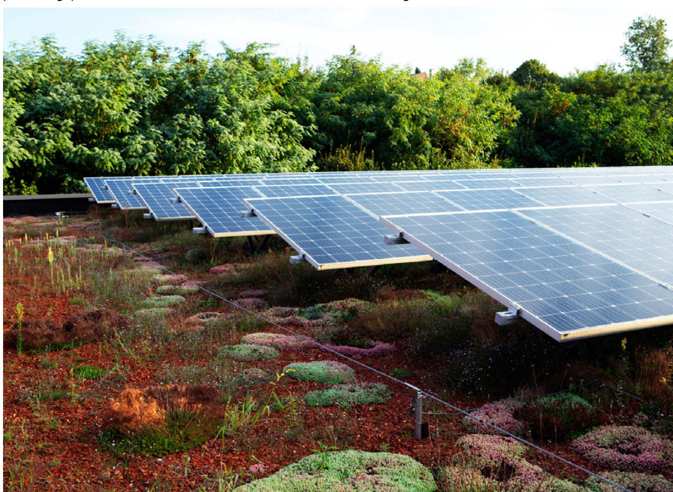
Figure 1: Installation PV combinée avec une végétalisation extensive, source: Contec
