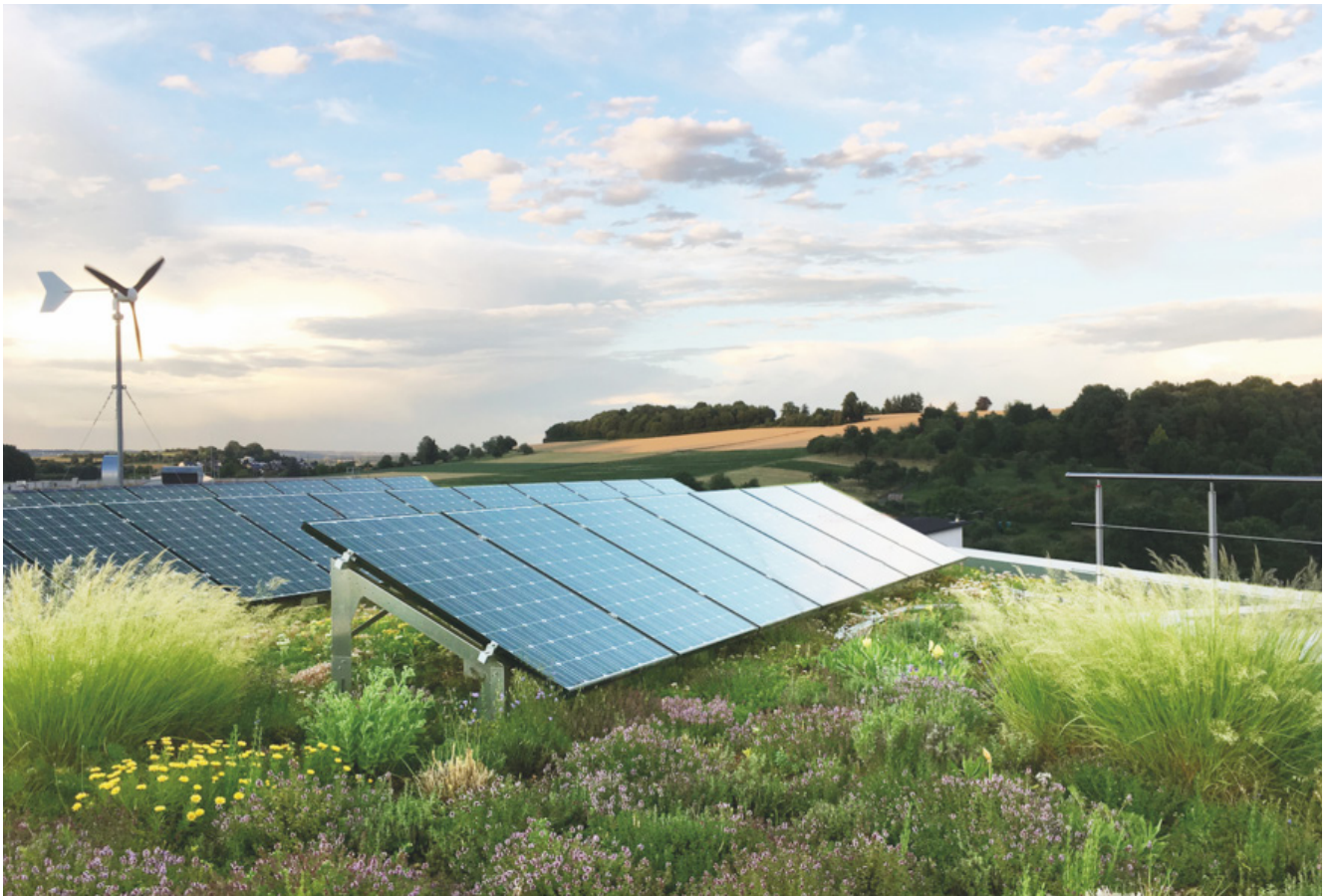
Figure 10: Combinaison d'une végétalisation intensive/extensive de la toiture à côté d'une installation PV, source: Zinco
