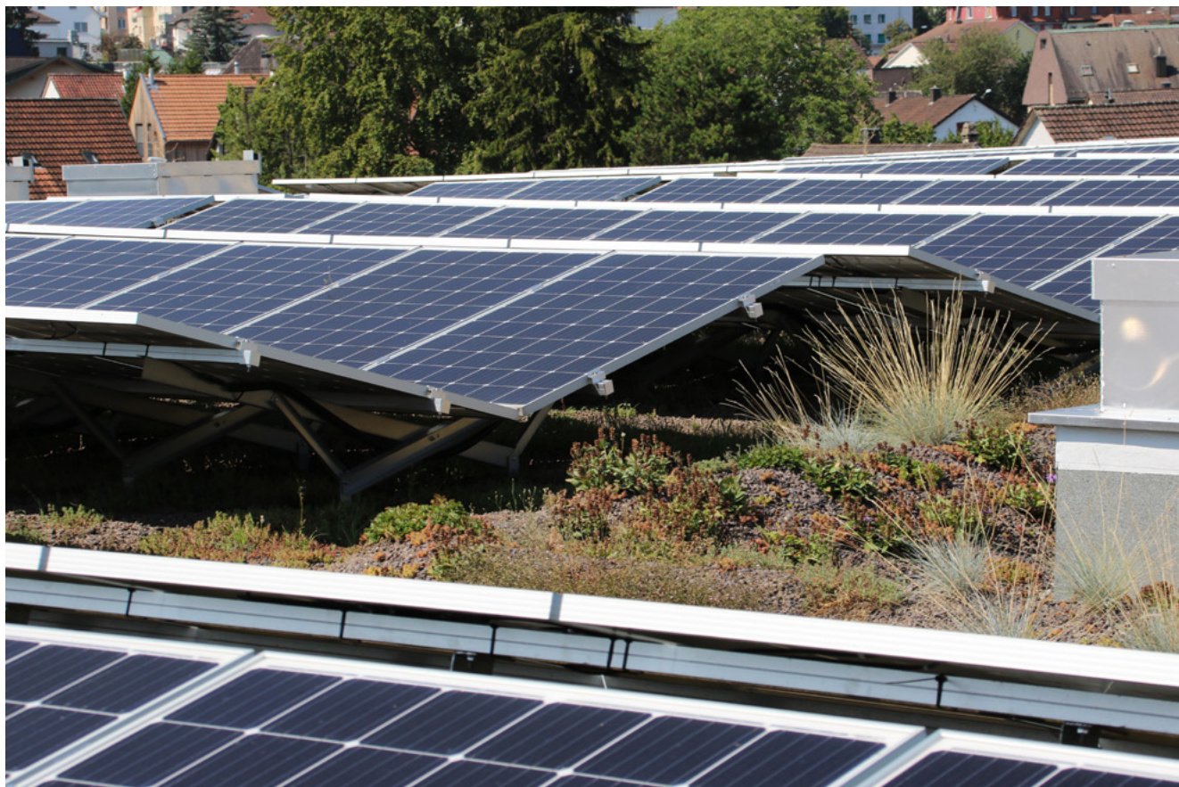
Figure 16: Installation PV orientée à l'est/ouest avec une structure de substrat modelée de hauteur différente, source: Zinco
