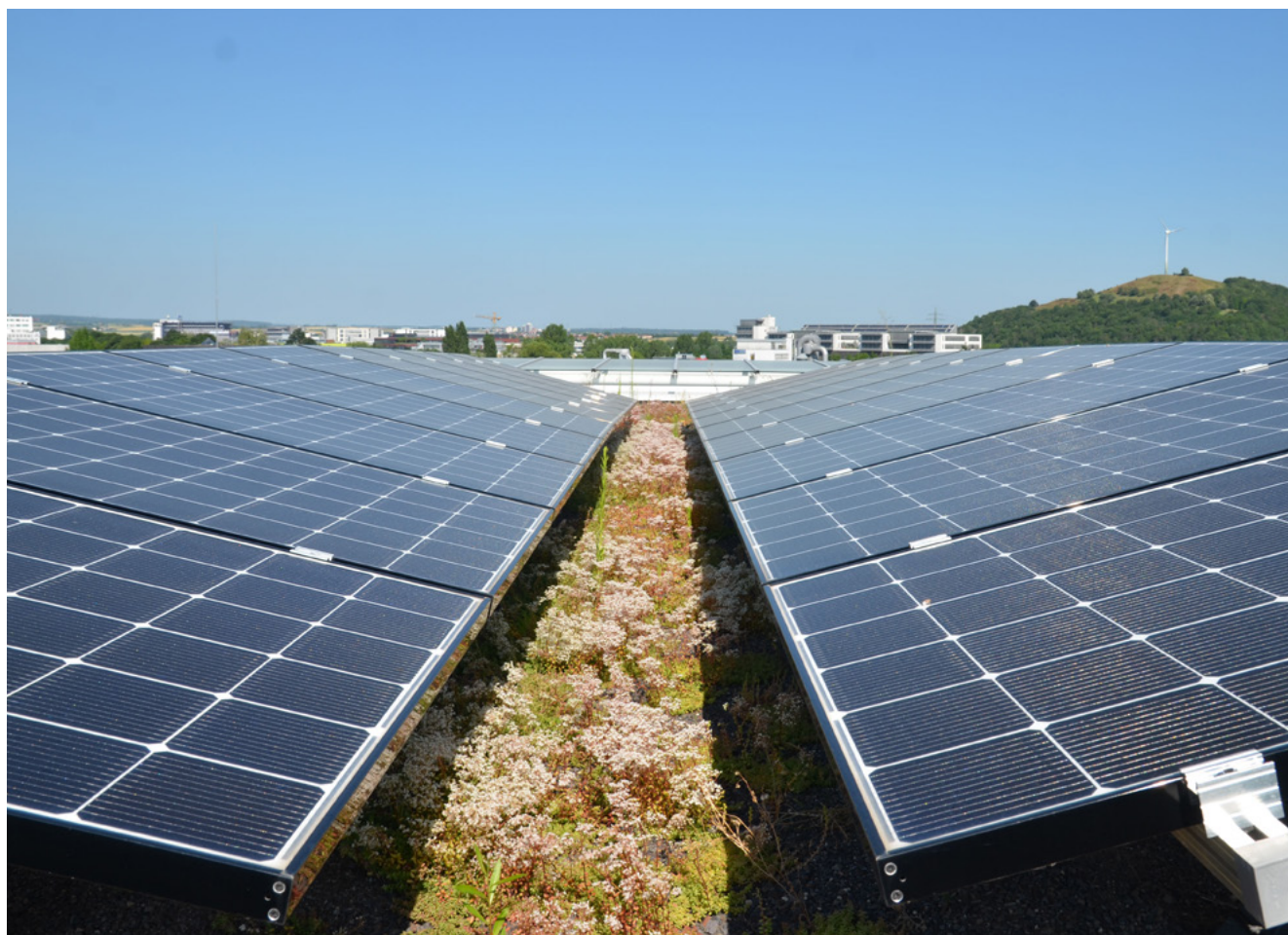
Figure 13: Installation PV orientée à l'est/ouest avec une structure de substrat minimale, source: Bauder
