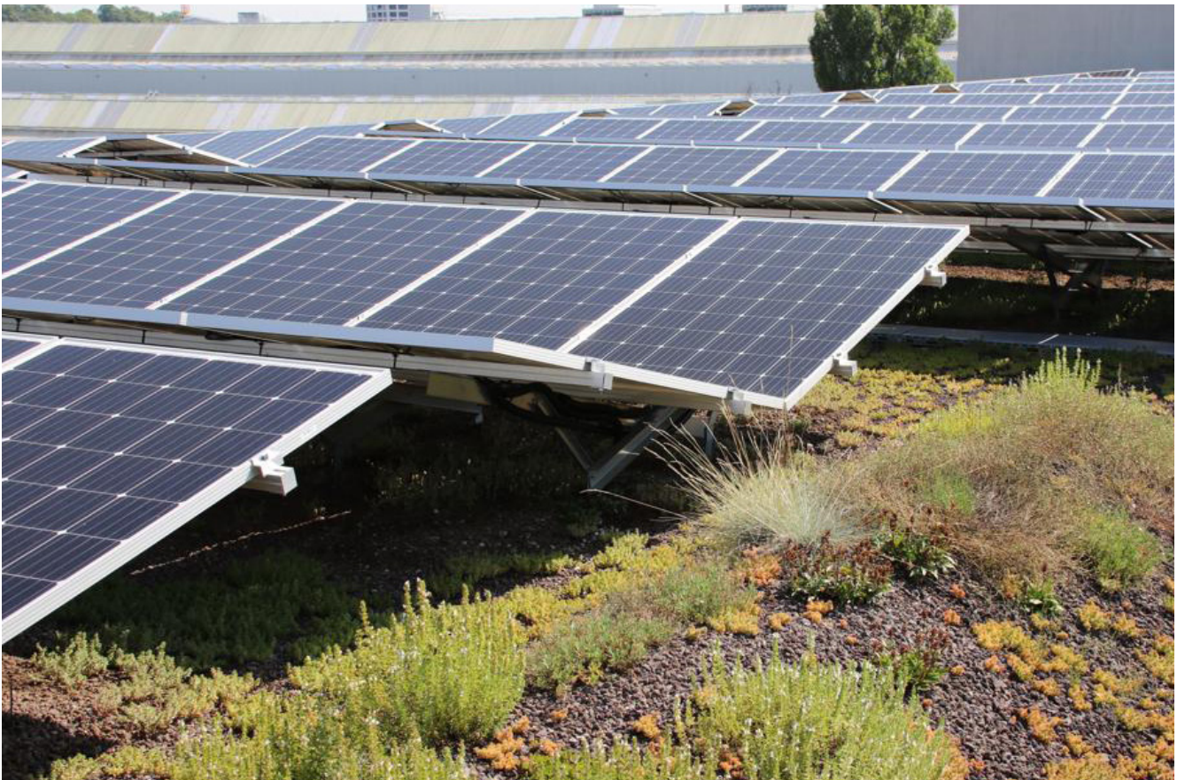
Figure 15: Installation PV orientée à l'est/ouest avec une structure de substrat minimale, source: Zinco
