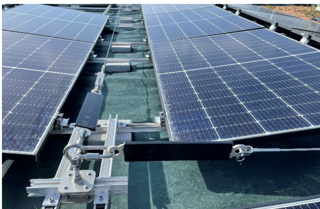
Figura 11: ABS X-Lock Solar su sistema K2-Dome. Fonte: ABS Absturzsicherung AG
