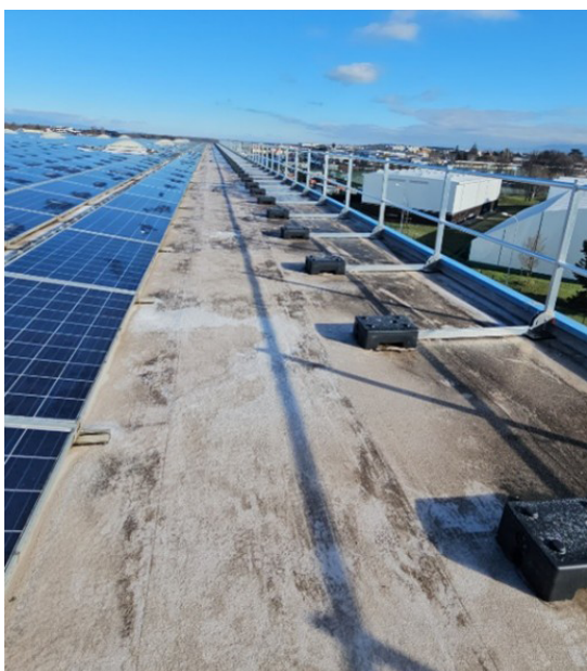
Figura 21: Bordo del tetto messo temporaneamente in sicurezza tramite parapetto zavorrato. Fonte: FPS Concept Sàrl
