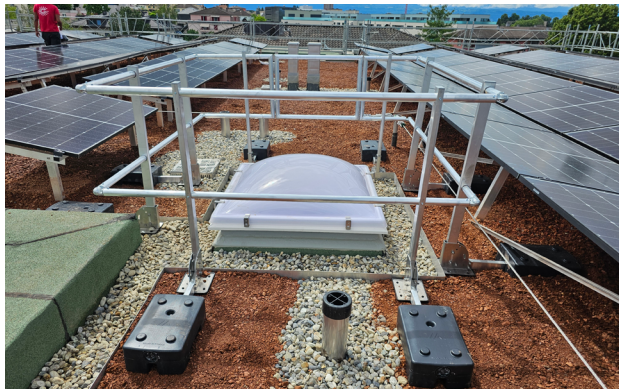
Figura 25: Messa in sicurezza permanente di lucernari a cupola o a banda mediante parapetto. Fonte: FPS Concept Sàrl
