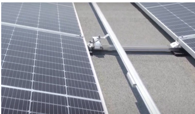
Figure 13: INNOTECH TAURUS, : linea vita a binario su impianto FV Fonte: INNOTECH Arbeitsschutz GmbH
