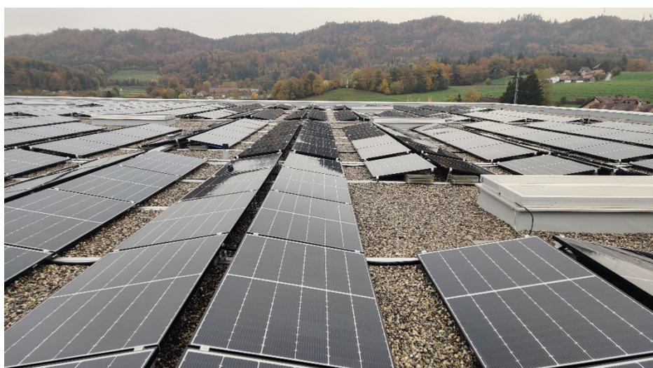
Figura 7: Grande impianto fotovoltaico con corridoi di manutenzione. Fonte: Migros
