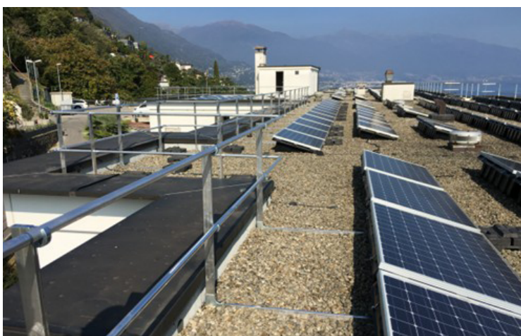
Figura 22: Bordo del tetto messo in sicurezza mediante parapetto permanente. Fonte: Gerry Wetterwaldd
