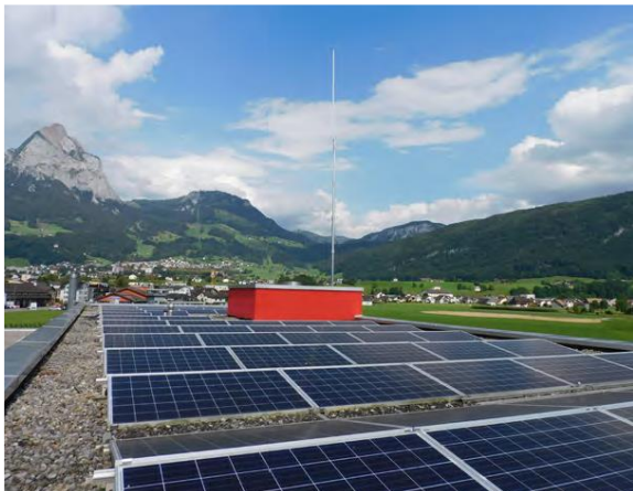
Figure 22 : installation posée sur la toiture plate du bâtiment de bureaux d'Auto AG Schwyz, photo : AUTO AG SCHWYZ
