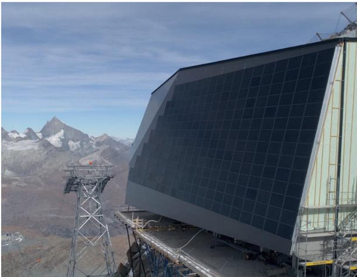
Figure 9 : station supérieure avec façade PV, photo : Zermatt Bergbahnen AG
