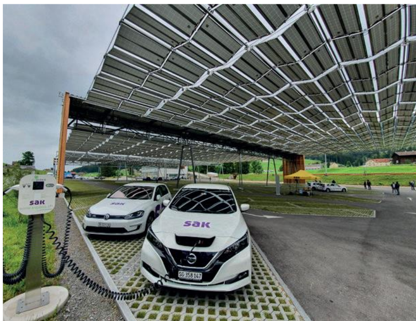
Figure 25 : toit solaire pliable sur le parking du téléphérique du Kronberg, photo : St. Gallisch-Appenzellische Kraftwerke AG (SAK)
