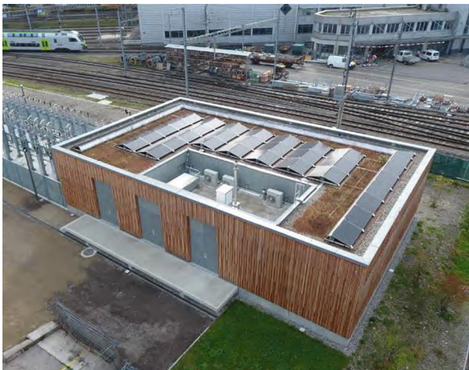
Figure 14 : station transformatrice de Holligen, avec installation PV sur la toiture, photo : BLS AG, Pascal Mürger
