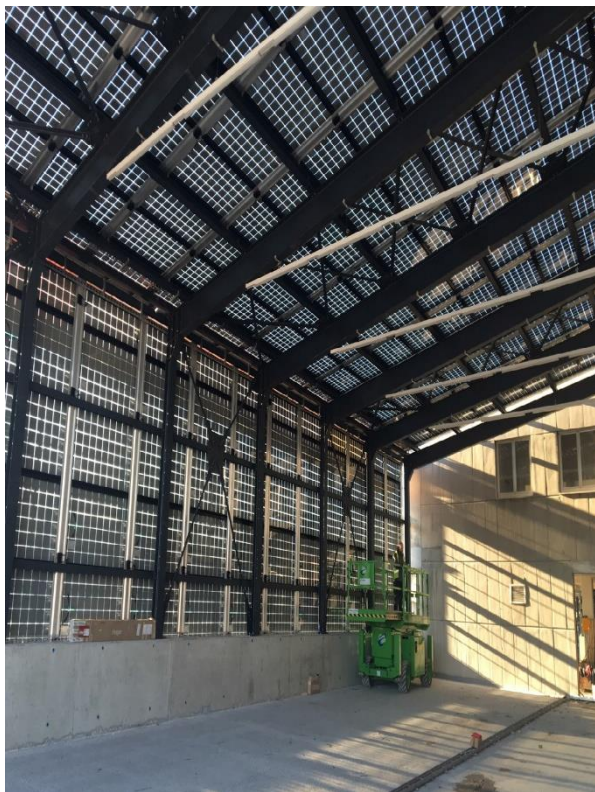
Figure 16 : parvis solaire CFF Cargo à MuttENZ, photo : © Prix Solaire Suisse 2017
