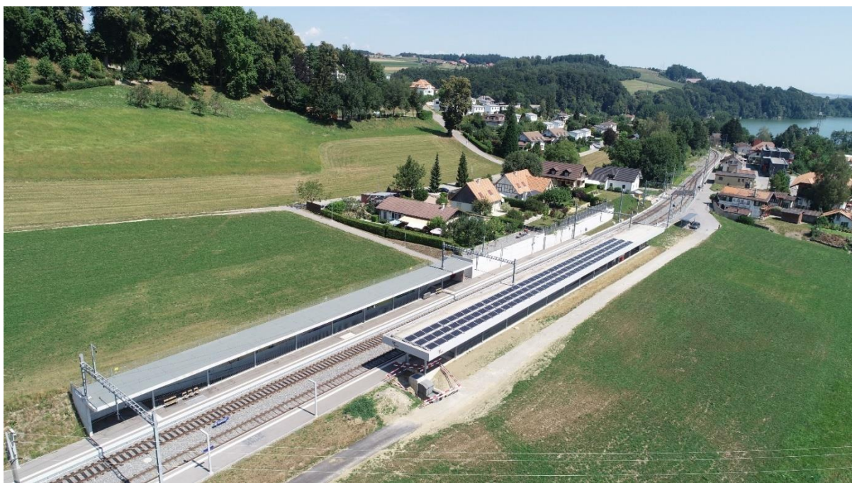
Figure 24 : installation PV sur le toit du quai de l'arrêt de Pensier, photo : TPF
