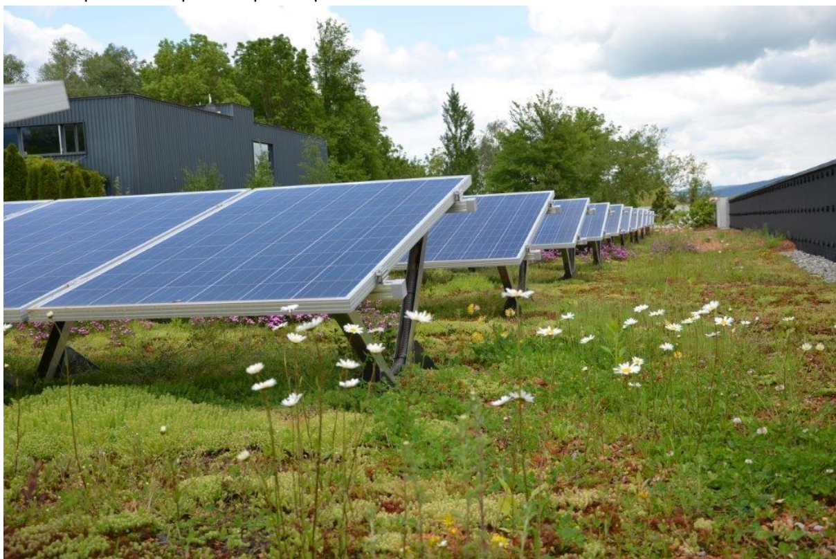
Figure 34 : toiture végétalisée combinée avec une installation PV, photo : Contec
