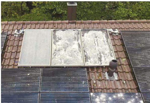
Abbildung 2: Durch Hagel beschädigte PV-Anlage und Solarthermie-Anlage, Bild: Ernst Schweizer AG
