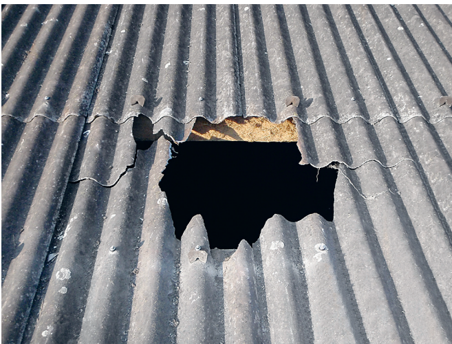
Fig. 8: Rupture de panneaux en fibrociment ondulés
