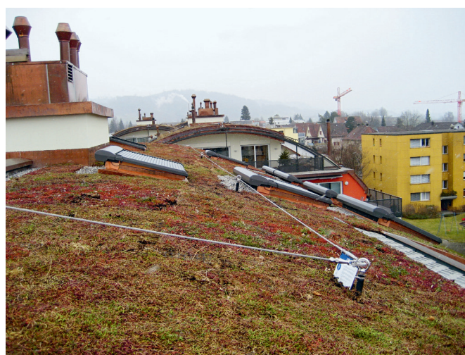
Fig. 6: Classe d'équipement 2; système de ligne de vie sur un toit en berceau végétalisé
