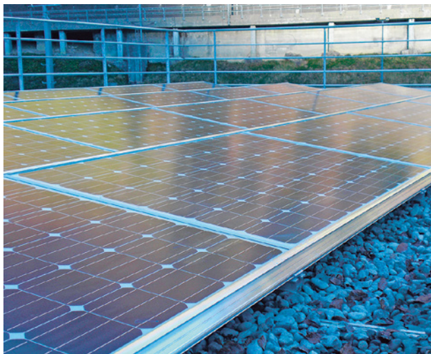
4 Impianto solare su tetto piano con parapetto perimetrale fisso
