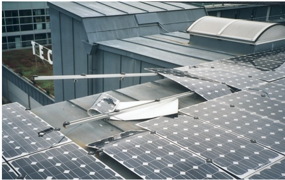
Abbildung 3: Modulschaden nach Sturm, Edisun
