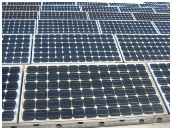
Abbildung 2: Verfärbung der Module (browning), Jendra Power AG$
