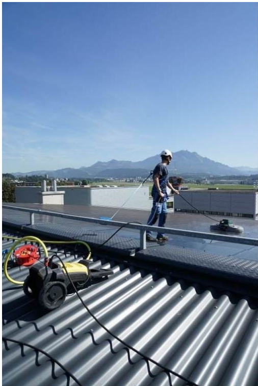
Abbildung 10: Reinigung Solaranlage, BE Netz AG
