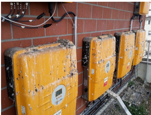
Abbildung 4: Verschmutzte Wechselrichter, Jendra Power AG
