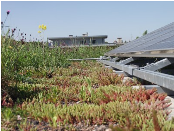
Abbildung 12: Sedum-Zone vor den PV-Modulen, Dr. Stephan Brenneisen, ZHAW Wädenswil
