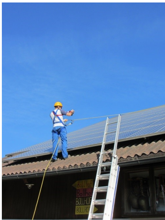
Abbildung 9: Anseilschutz, BE Netz AG
