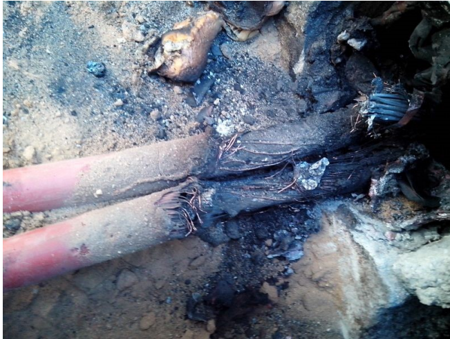
Abbildung 7: Kabelbrand, Jendra Power AG
