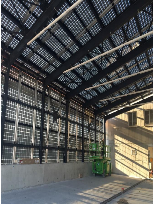
Abbildung 16: SBB Cargo Anbau in MuttENZ, Bild: © Schweizer Solarpreis 2017
