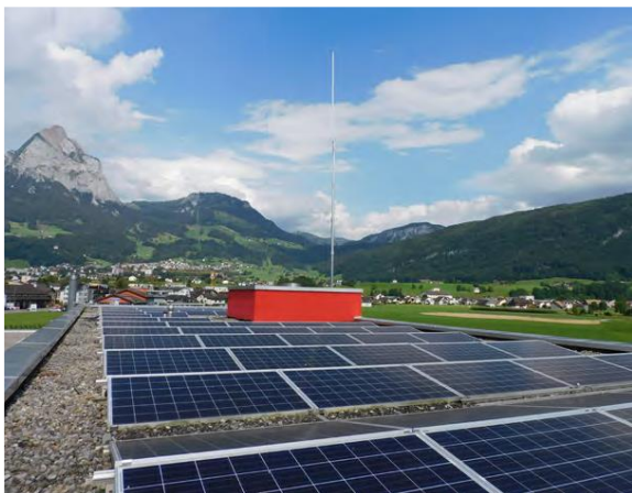
Abbildung 22: Flachdachanlage auf Bürogebäude Auto AG Schwyz, Bild: AUTO AG SCHWYZ
