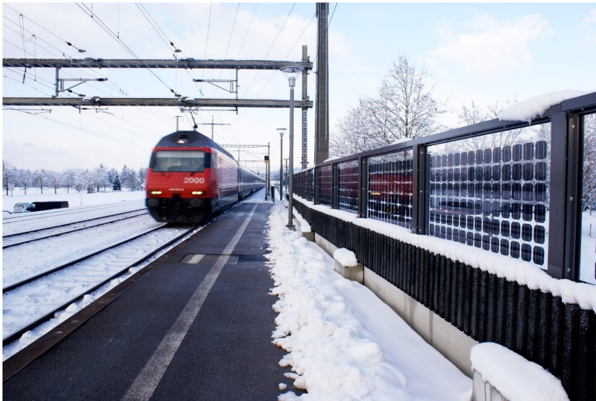
Abbildung 46: Lärmschutzwand mit bifacialen Solarmodulen in Münsingen, Bild: TNC Consulting AG
