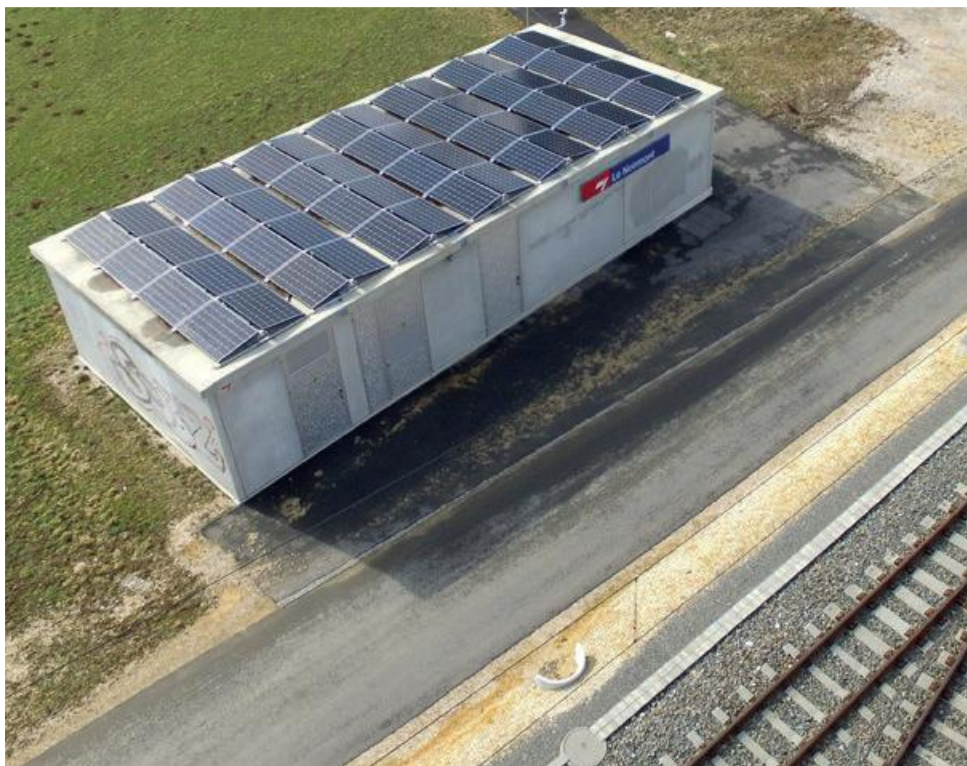
Abbildung 12: Bahntechnikgebäude in Le Noirmont, Bild: Société des Forces Electriques de La Goule SA
