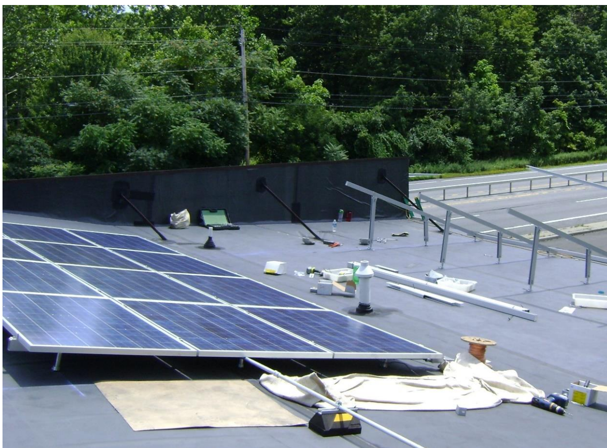
Abbildung 5: Installation PV-Module auf Flachdach, Bild: Lucas Braun / CC BY-SA 3.0 ( www.creativecommons.org/licenses/by-sa/3.0 )
