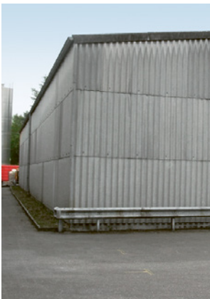
1 Mit asbesthaltigen Platten verkleidete Fassade
